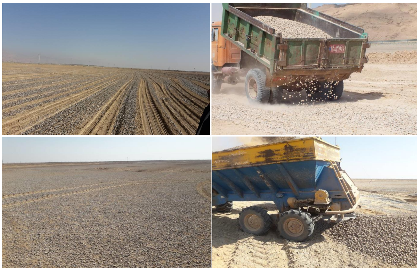
شکل ۲-۴۵- الف) پاشش سنگریزه با استفاده از کمپرسی؛ ب) عدم یکنواختی در پاشش سنگریزه با استفاده از کمپرسی؛ ج) پاشش سنگریزه با استفاده از کودپاش اصلاح شده؛ د) یکنواختی نسبی در پاشش سنگریزه با استفاده از کودپاش اصلاح شده
