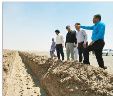
بازدید مدیر کل منابع طبیعی و آبخیزداری استان کرمان از پروژه ی در حال اجرای احداث تله رسوبگیر در منطقه نگین کویر به گزارش پایگاه اطلاع رسانی اداره کل منابع طبیعی و آبخیزداری کرمان
